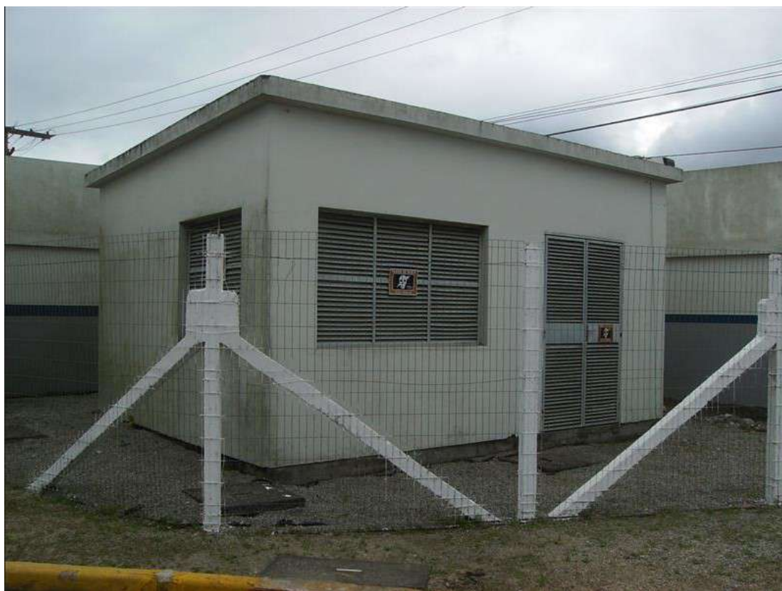
Imagem 11 – Subestação descrita no item 10 (em 2016).
