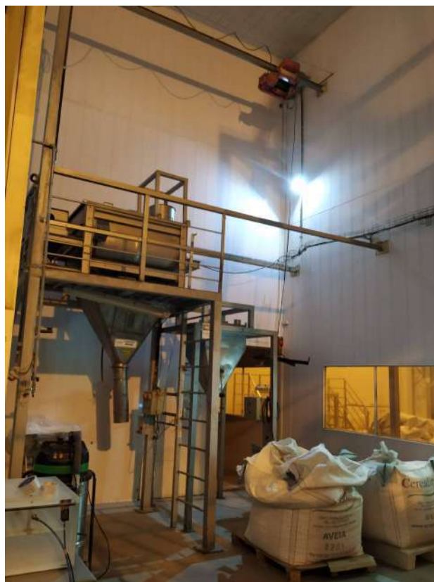
Vista Geral embaladora auxiliar mix
